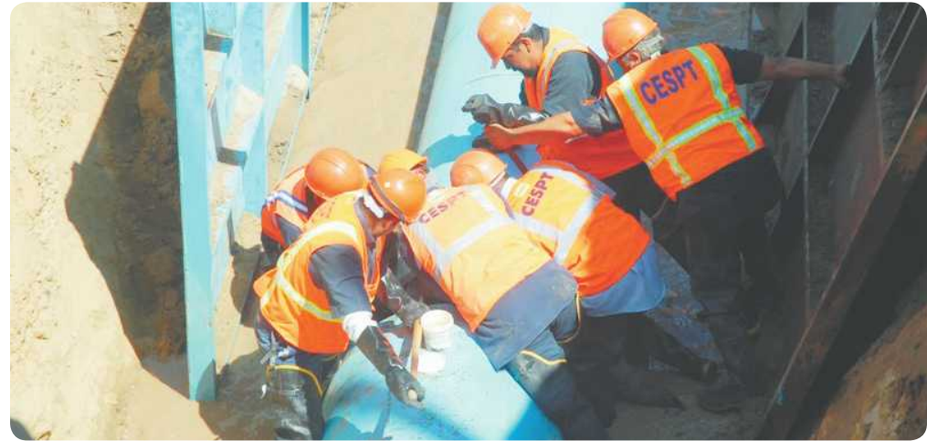
TIJUANA.- La CESPT controló una fuga de agua en Playas de Tijuana.
