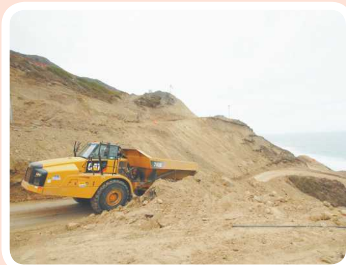
ENSENADA.- Los estudios geológicos revelaron que hay varios tipos de suelos, uno en particular es duro como la piedra pero en presencia de agua se vuelve gelatinoso y eso ocasionó el deslizamiento del suelo.
