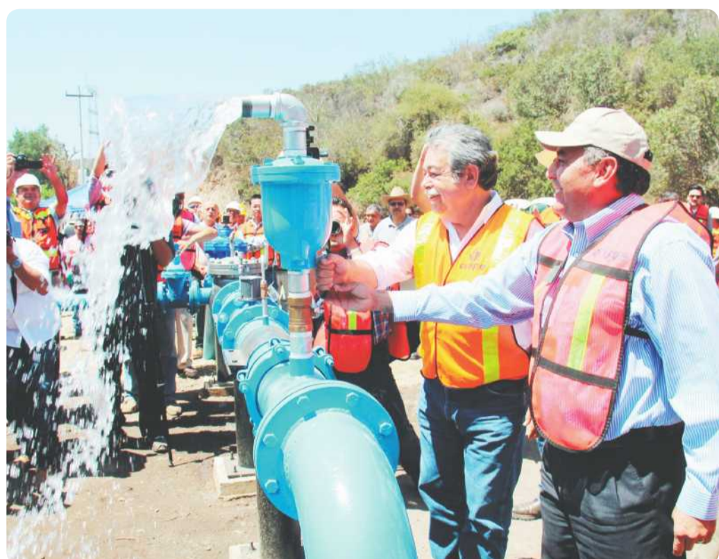
La obra fue inaugurada ayer y se espera que el agua potable ya llegue a las casas de manera regular.
